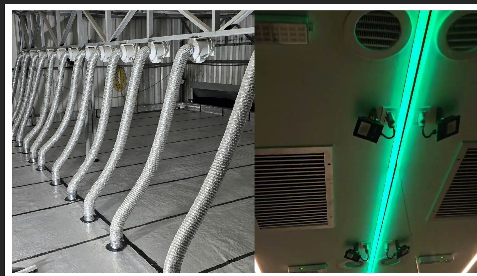
Exaustores do corredor quente
