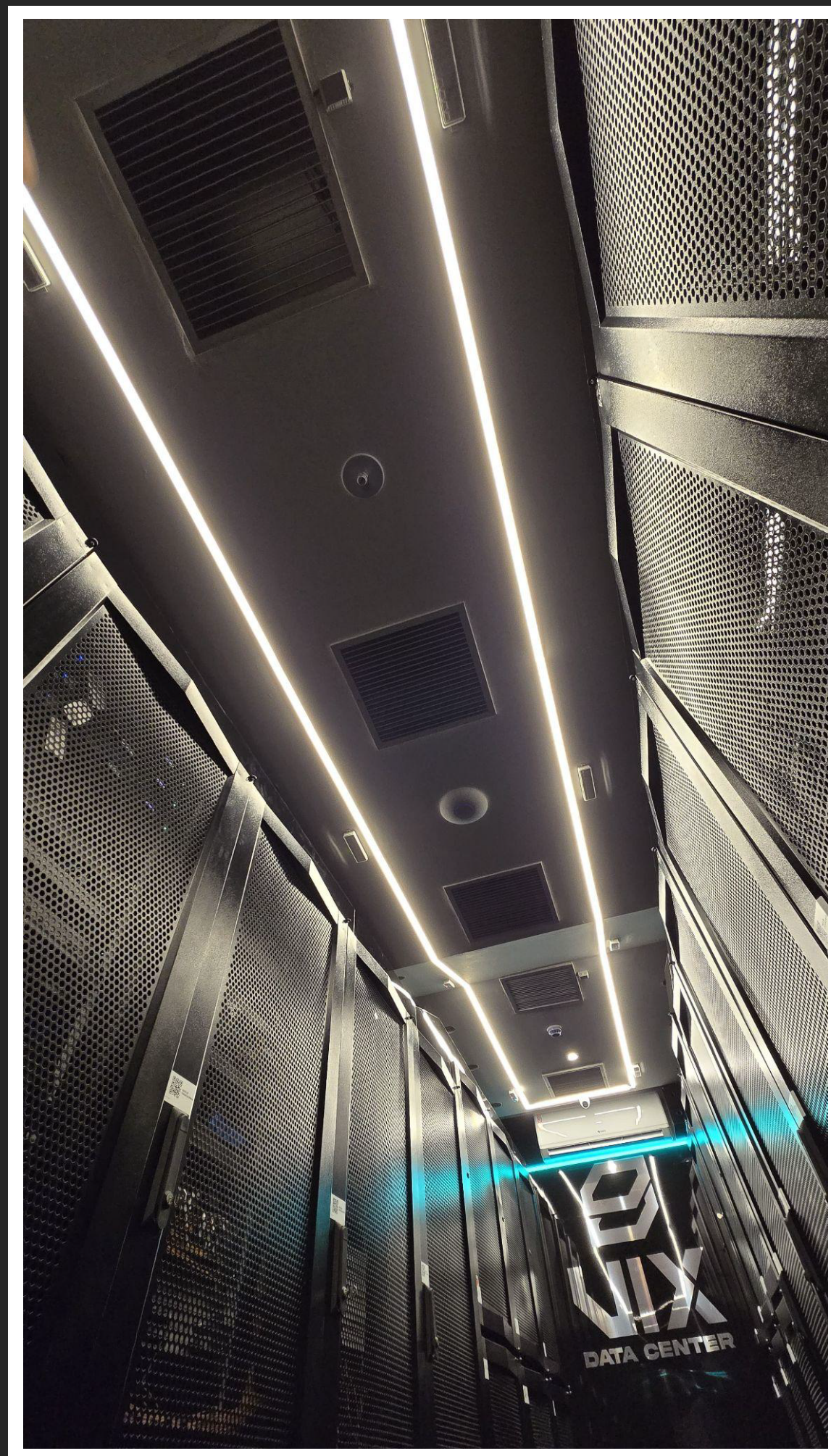
Ar-condicionados de Precisão
