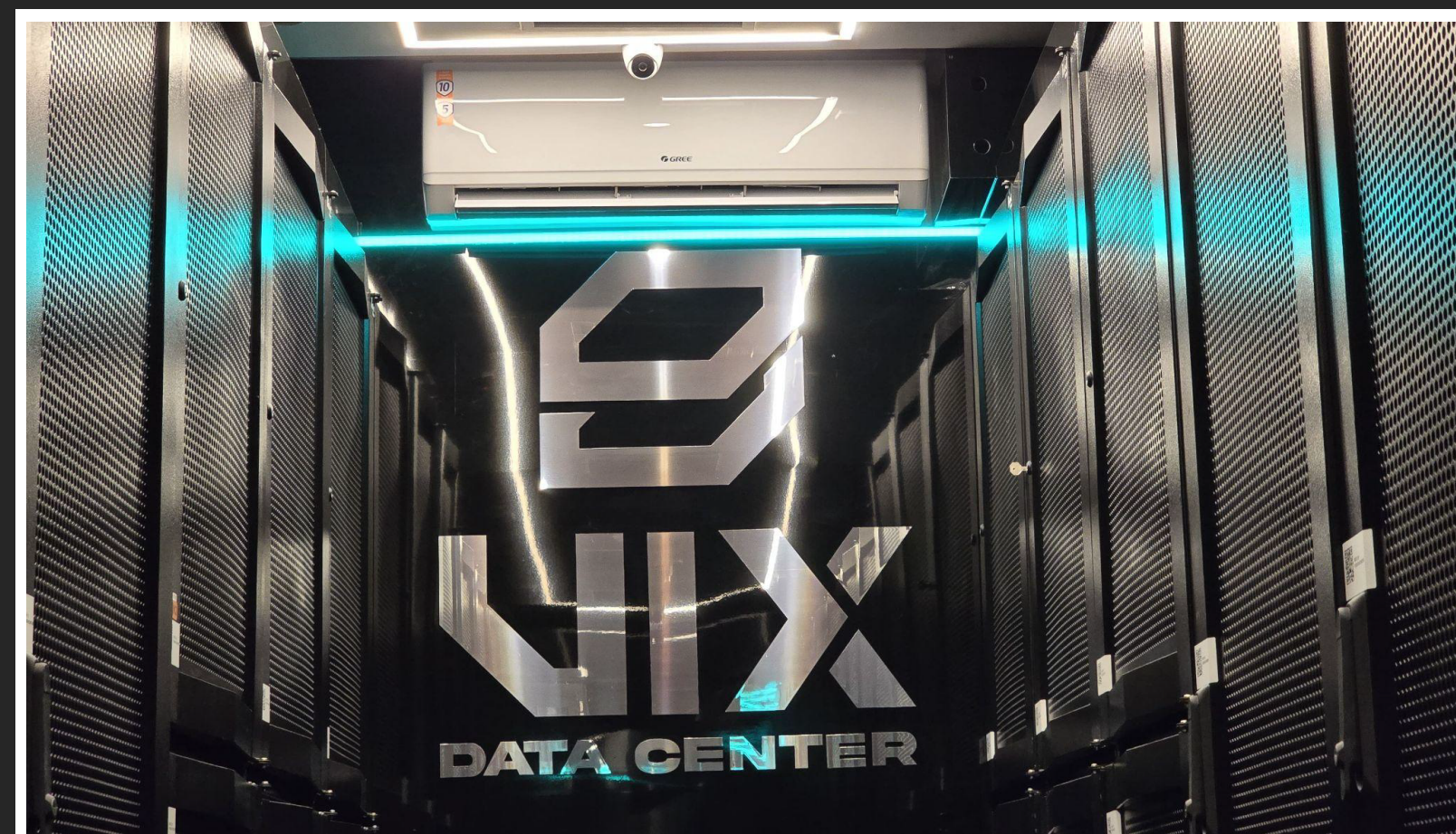
Redundância ar-condicionado split
